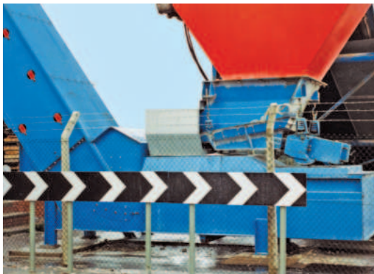
Контролируемая подача через вибропитатель в ленточный конвейер
