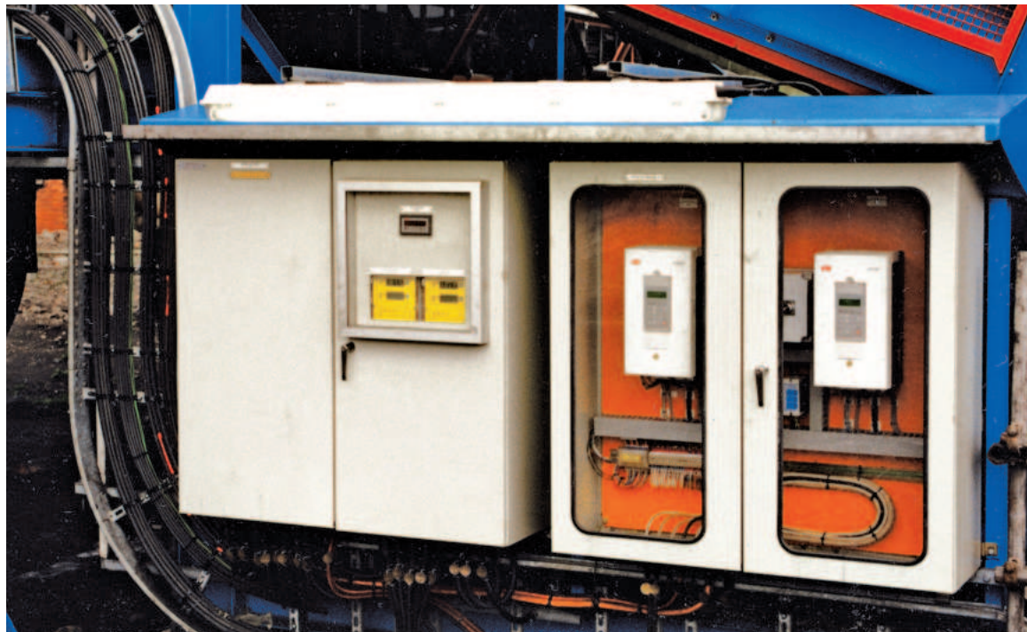
Модули частотного регулирования скорости, установленные на питателе Samson®, но соединенные с удаленным пультом управления
