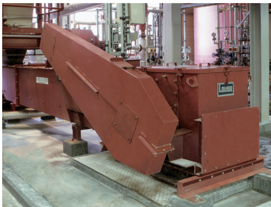
Двухрядный цепной транспортер перегружает синтетический гипс из установки десульфатизации дымовых газов в силосы хранения
