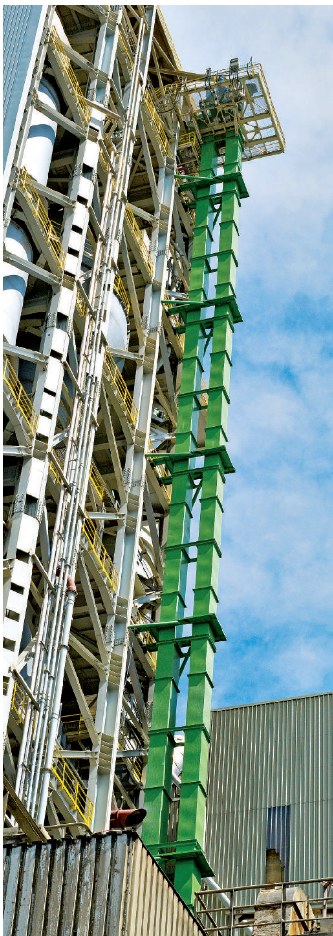
Подача материала на теплообменник
