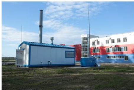
БМК 0,6 МВт, г. Брянск
